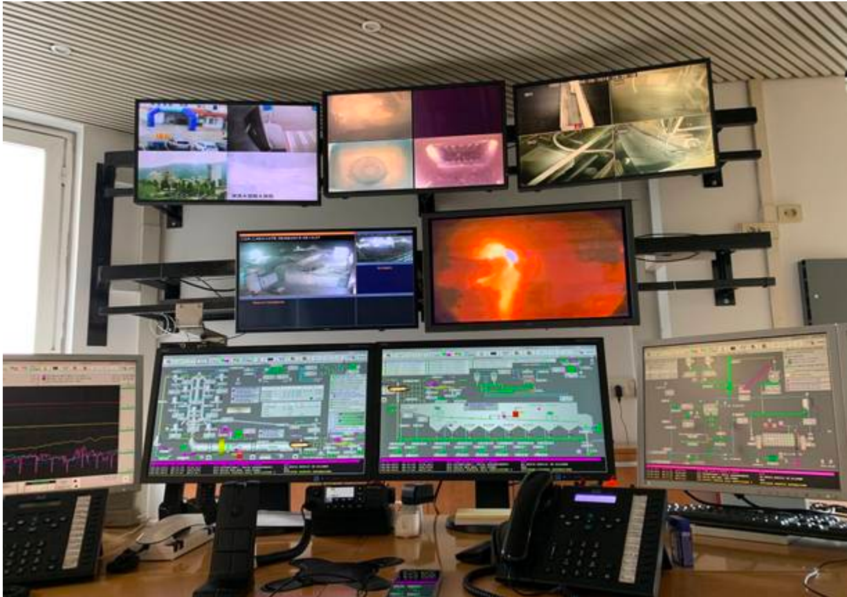
La sala di controllo
